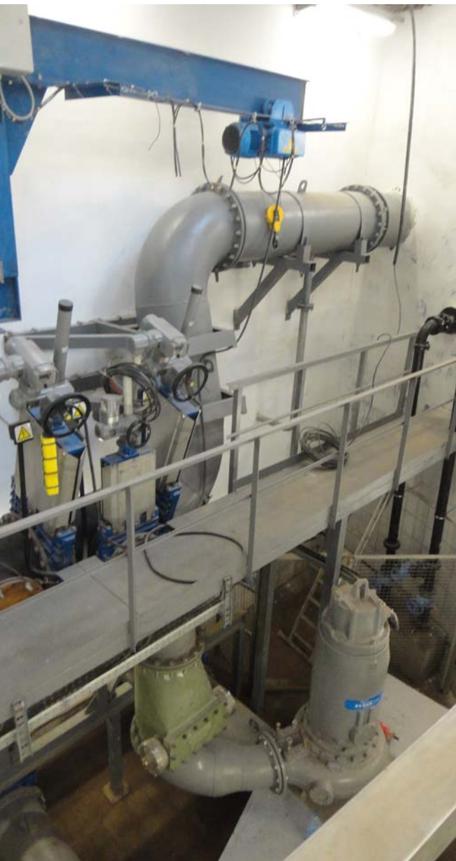
Рис. 6. КНС после РЕКОНСТРУКЦИИ. МАШИННЫЙ ЗАЛ
