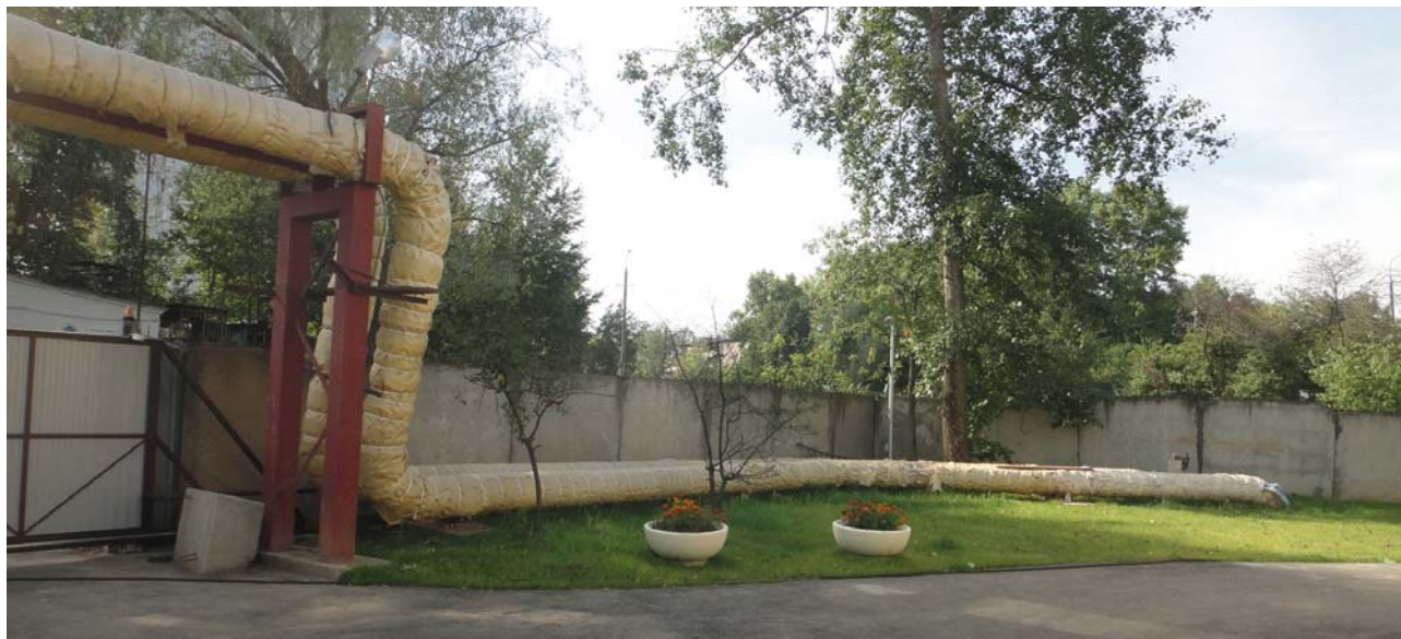
Рис. 5. Временные напорные трубопроводы
