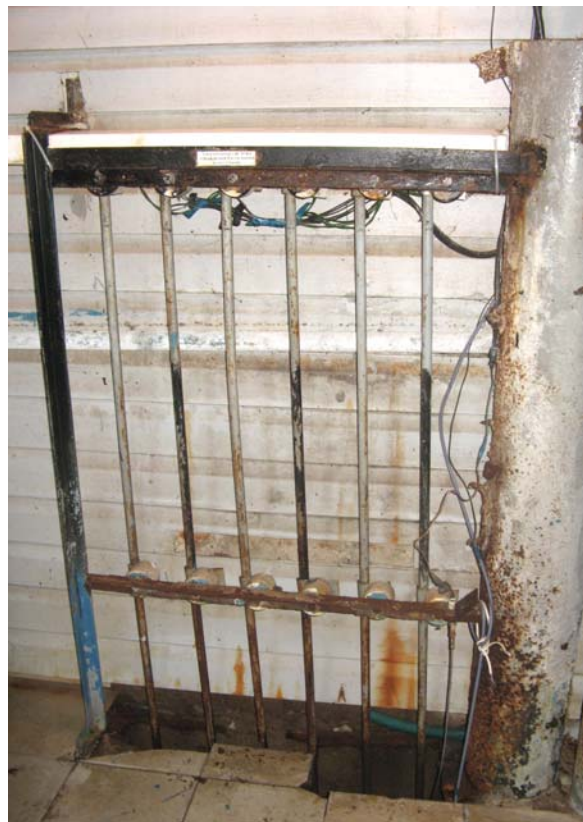
Рис. 2. КНС до реконструкции. Датчики уровня
