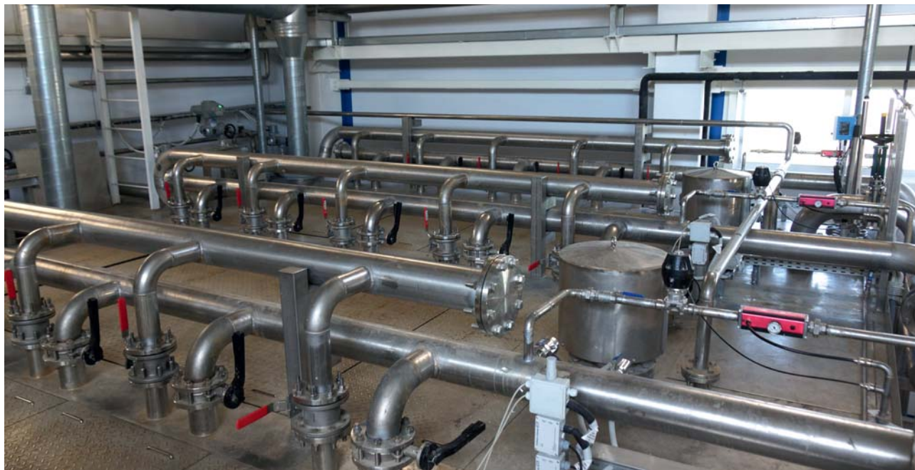
Рис. 10. Мембранные резервуары на ЛОС ООО «Пепсико Холдингс», г. Домодедово
