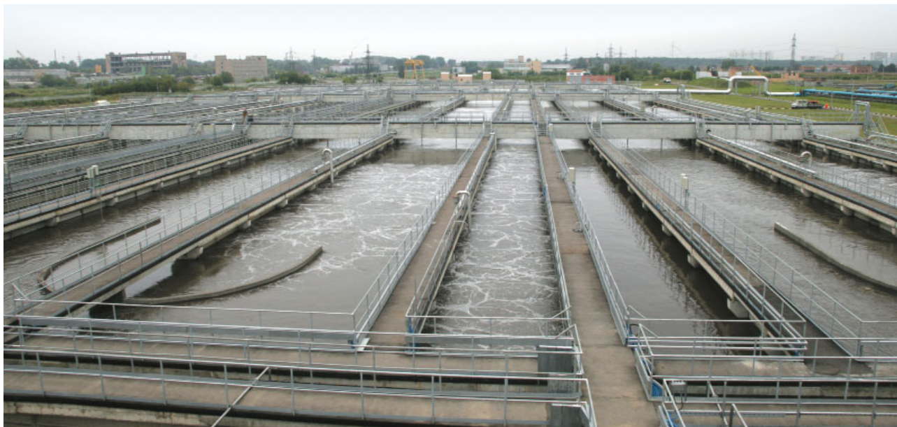
Блок удаления биогенных элементов, Люберецкие очистные сооружения, Москва. Первые новые крупные очистные сооружения, запроектированные в России по технологии удаления азота и фосфора, на основании собственных разработок и расчетов
