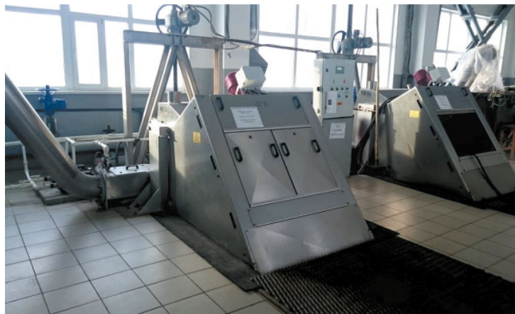
Рис. 4. Автоматические ступенчатые решетки
